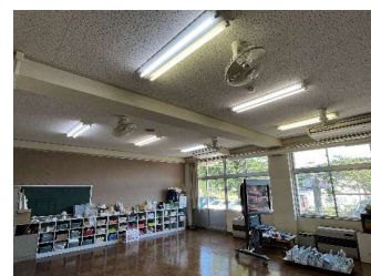
LED照明への更新
